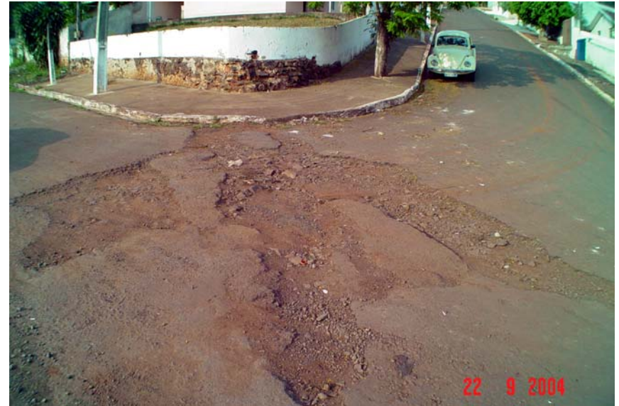
Fig. 3.2.10 – Processos erosivos nas vias pavimentadas adjacentes aos fundos de vale
