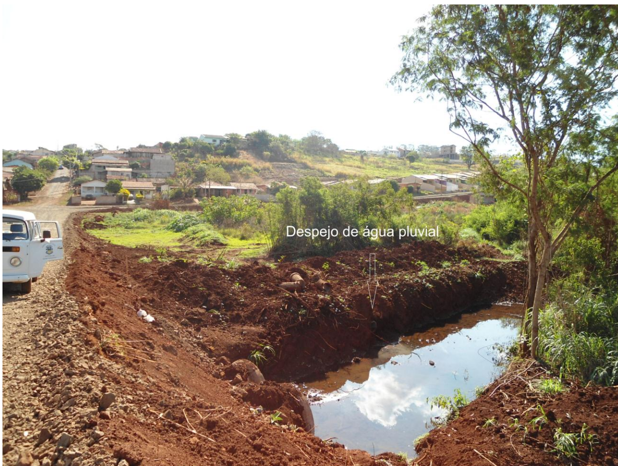
Figura 10 - Despejo de água pluvial próximo ao conjunto habitacional Bom Tempo e o bairro Sol Nascente.
