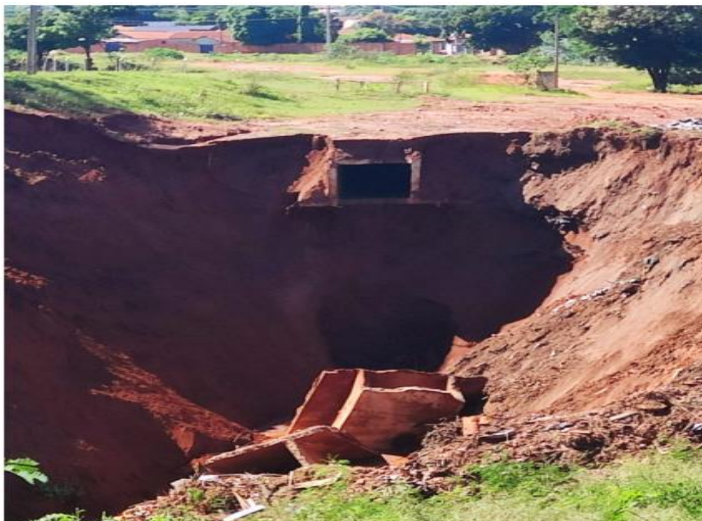
Macro drenagem em processo de destruição.
